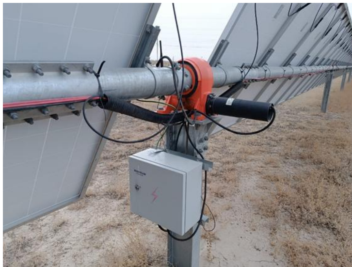
Рисунок 23 – Узел привода одноосной трекерной системы Arctech Solar на СЭС-1 (Туркестанская область)
